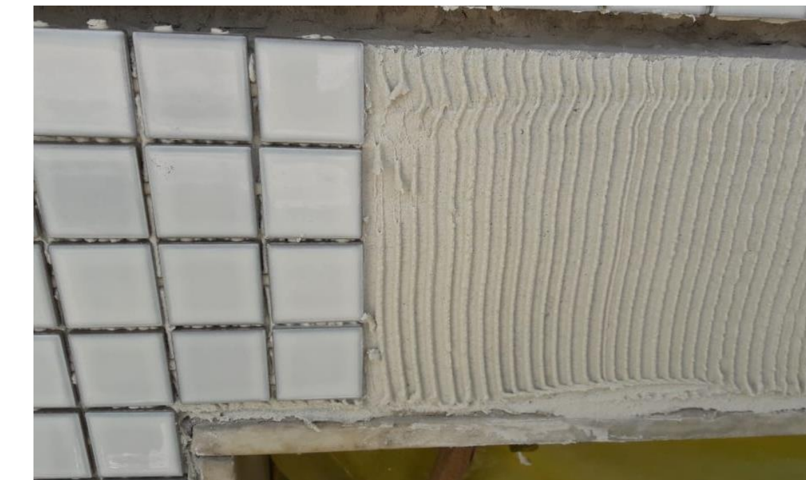
Figura 3. Placa de cerâmica na superfície da parede Fonte: Autor
